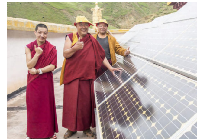
通威集团理塘公益项目太阳能发电站
