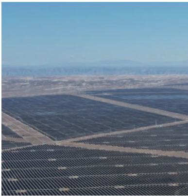
青海共和90万千瓦 光伏项目 项目容量 | 900MW
