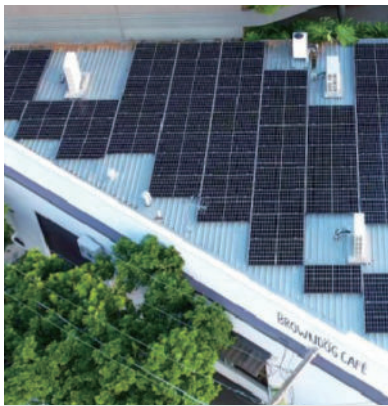
澳洲商铺屋顶项目 项目容量 | 30.71kW
