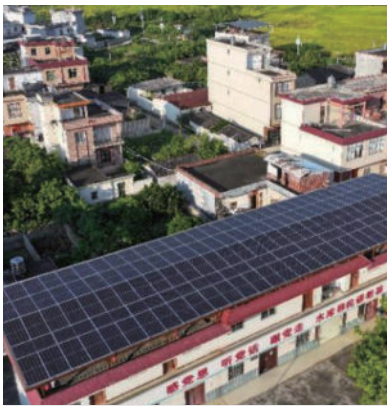
广西创维小阳楼光伏项目 项目容量 | 199.8kW
