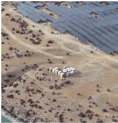
华电墨竹工卡扎雪牧光 互补光伏发电项目 项目容量 | 100MW
