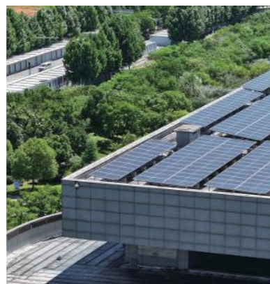
安徽铜陵企事业单位光伏项目 项目容量 | 10MW
