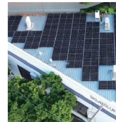
澳洲商铺屋顶项目
